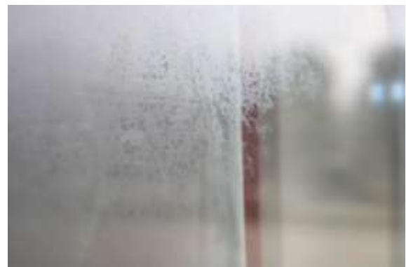
Rechte Bildhälfte: Hier war der Scheibenaufkleber des Herstellers auf der Scheibe befestigt (Oberfläche zum Lieferzeitpunkt) Linke Bildhälfte: Hier ist der nachträglich aufgekommene Belag zu sehen
